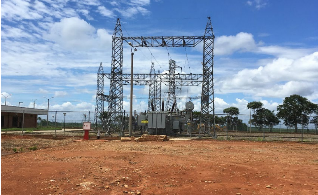
Planta de generación de energía.
